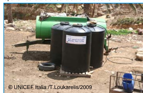
Cisterne idriche e depuratori mobili installati dall'UNICEF
